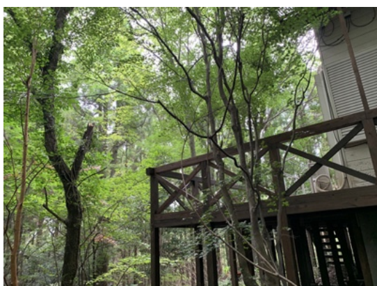
Z125 大雨強風被害 (倒木が室外機を直撃) 4 (2022年7月)
