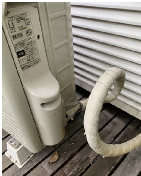
Z124 大雨強風被害 (倒木が室外機を直撃) 3 (2022年7月)
