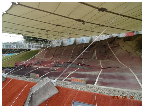
写真1：隆起したフィールドトラック
