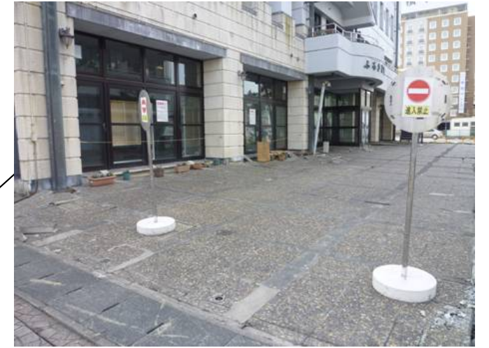
ふるさと館 周辺地盤の沈下
