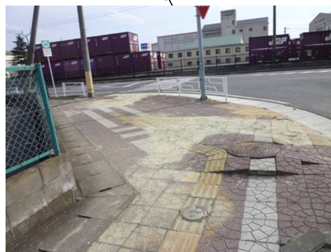
↑MH浮上 5cm程度, →MH浮上 25cm程度
