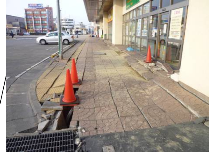
新幹線駅高架下のコンビニ前、噴砂跡
