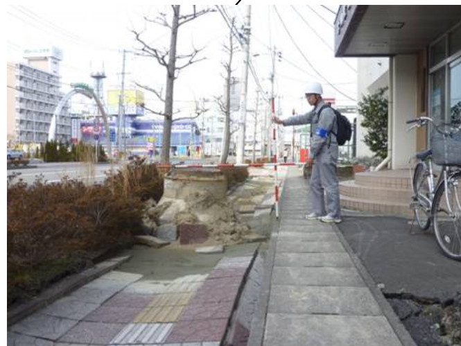
MH浮上 95cm(地表より90cm、周辺地盤5cm沈下)
