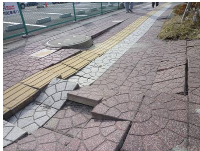
MH横の地盤が沈下
